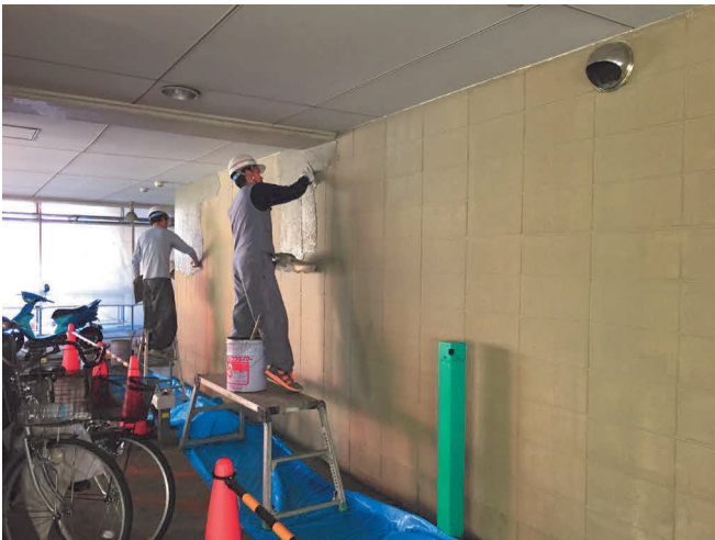
左官補修工事 下地補修後の意匠変更等のバリューアップ工事 も行います。
